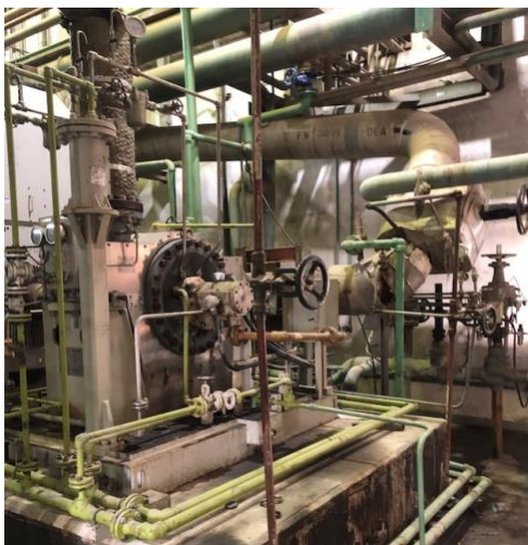
写真2 3号機ボイラー設備（給水ポンプ） （出典：現地調査補助員撮影）
