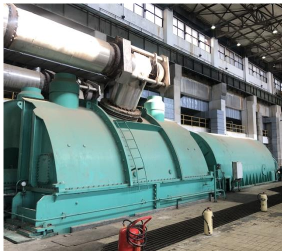
写真3 3号機タービン・発電機 （出典：現地調査補助員撮影）
