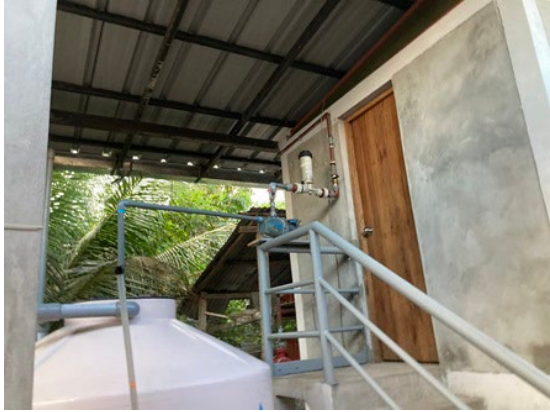
雨水による給水施設に住民が設置した電動ポンプ
