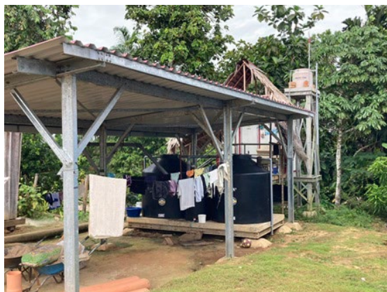
雨水による給水施設 1
