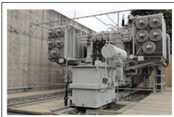
変電所港 (L) 220/132/33kV 変圧器 (評価者撮影)
