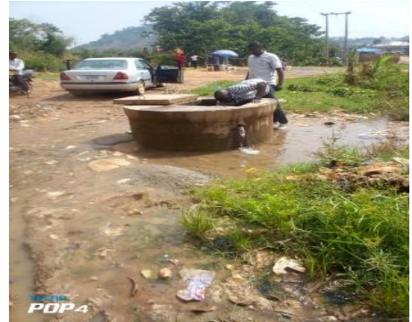
4. アボ地区で漏水が検出された箇所（二箇所目）
