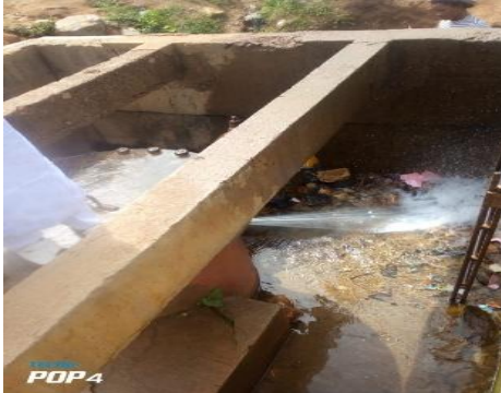
3. アボ地区で漏水が検出された箇所（一箇所目）
