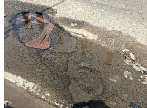
写真14 下水管からの漏水によるポットホール（2024年11月）2025年3月にリベリア上下水道公社により漏水修理済（出典：評価者）
