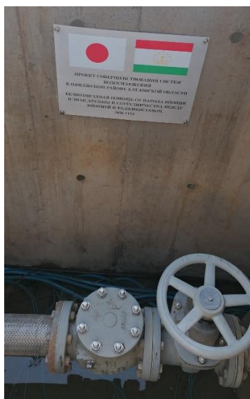
写真1 取水井戸 (現地調査補助員撮影)
