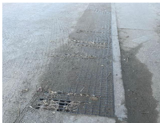
写真6 側溝の詰まりの様子 (出典：外部評価者撮影)
