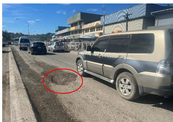
写真 3 中央市場前の道路の劣化の様子 （赤囲みが劣化した道路の様子） （出典：外部評価者撮影）
