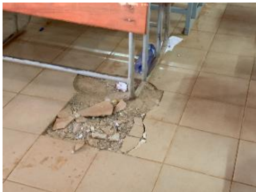
写真 13：教室の床のタイルが剥がれている様子
