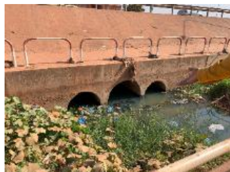
写真4：横断排水溝のはけ口部に土砂が堆積している様子（出典：評価者撮影）
