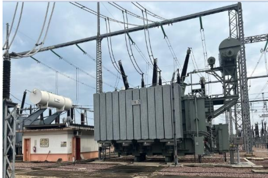
写真2 インフレネ変電所 T2 変圧器 (出典：外部評価者撮影)
