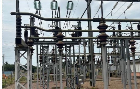
写真3 インフレネ変電所 66kV 断路器 (出典：外部評価者撮影)
