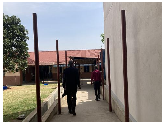
写真2 屋根が未完成であるアルア RRH の連絡通路（出典：評価者撮影）
