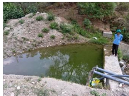
写真 8：カングラ県の揚水灌漑地区の堰で発生した沈泥（KVA で過去に対策が講じられたものの沈泥が継続）（出所：評価者撮影）
