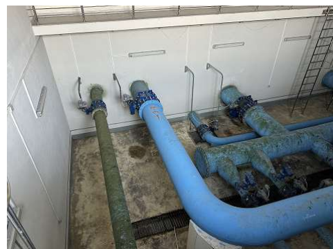
写真 3：上水施設（原水導水管）（ナフタラン）（出典：評価者撮影）
