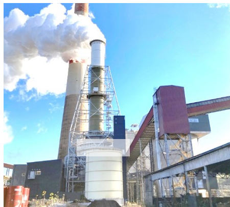
排煙脱硫装置 3
