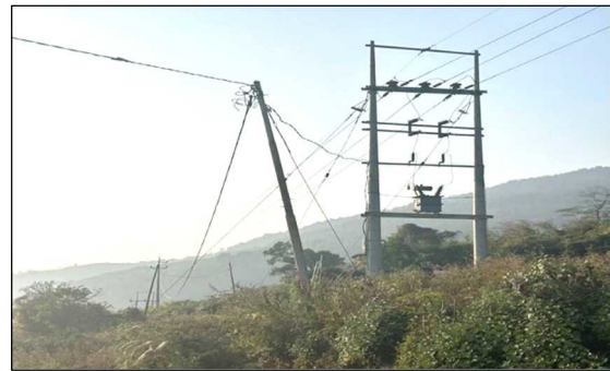
本事業の配電変圧器と 33kV 配電線 (チュカ県ゲテナ・ゲオグ 4 ) (出典：評価者撮影)
