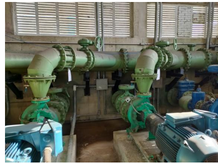
写真4：建屋内のブースターポンプ (出典：評価者撮影)
