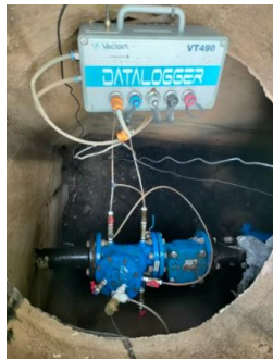
写真3：コンクリートピット内の減圧弁 (出典：評価者撮影)
