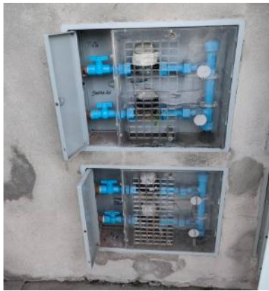
写真1：壁埋め込み式給水装置 (出典：評価者撮影)
