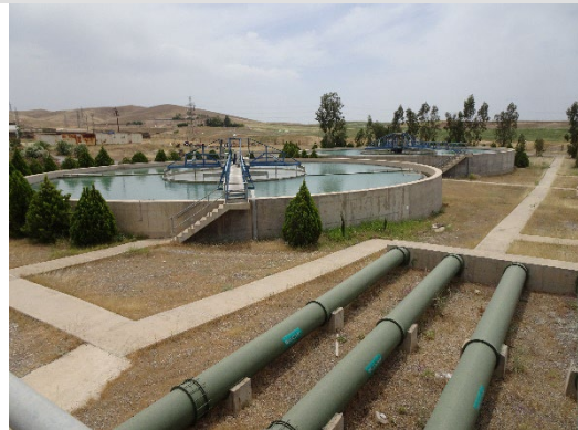
本事業で拡張された浄水場（エルビル市） （出典：評価者撮影）
