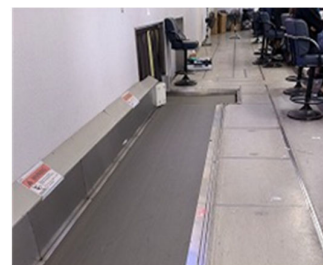
国際線チェックインカウン ター裏の手荷物搬送設備
