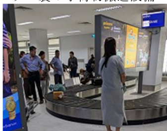
国内線手荷物搬送設備
