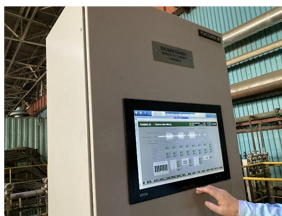
写真 8：蒸気タービン・発電機の稼働確認用電子機器（出典：評価者撮影）
