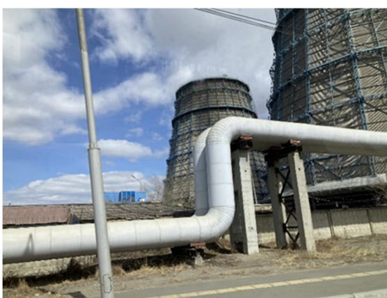
写真 6：第 4 火力発電所から市内に供給する熱（温水）管（出典：評価者撮影）
