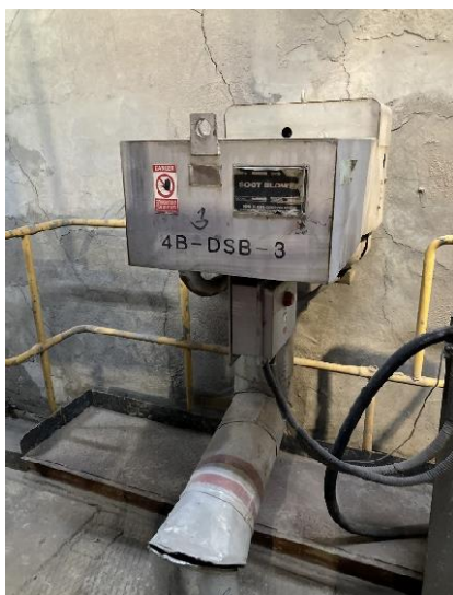
写真1: 煤吹機（スーツブロワ）（全自動式） （出所：評価者撮影）
