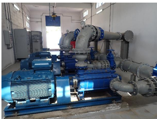
写真1 タウナート県のポンプ場の様子 (出典：評価者撮影)
