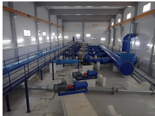
写真2 浄水場内送水ポンプの様子 (出典：評価者撮影)
