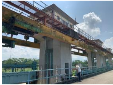
写真2 取水堰調整ゲート (出典：評価者撮影)
