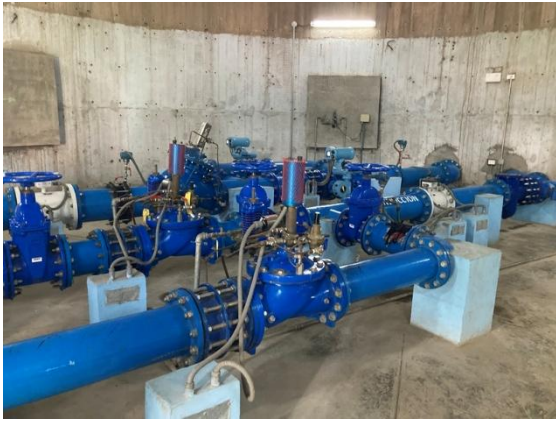
写真1 配水池内のバルブ
