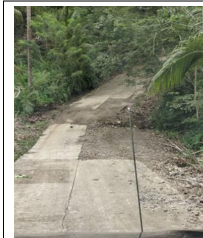
写真3：地震で損壊した市場アクセス道路 (出所：評価者撮影)
