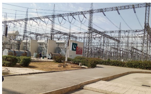
ニューラホール変電所全景
