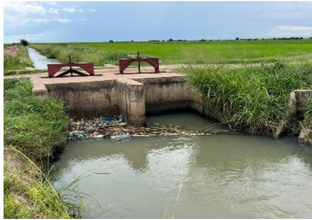
本事業で整備された水路と分水ゲート。 サイト名：Mwamapuli (出所：評価者撮影)
