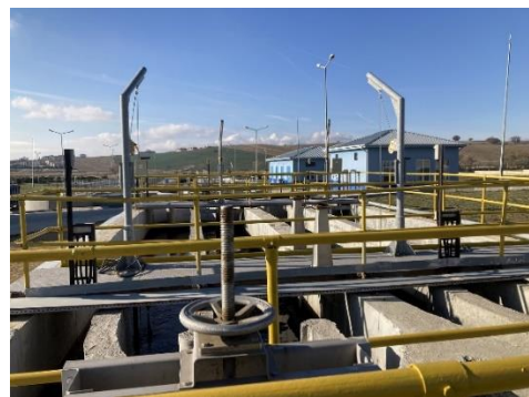
整備された下水処理施設 (テキルダー県テキルダー東地区) (出典：評価者撮影)
