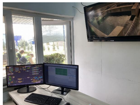
写真 4：導入された SCADA システム (テキルダー県テキルダー西地区) (出典：評価者撮影)
