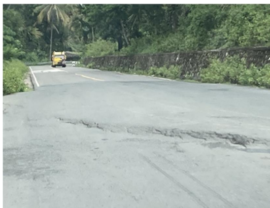
写真 5：マナツト～バウカウ間道路で凹凸が生じている箇所（出典：評価者撮影）
