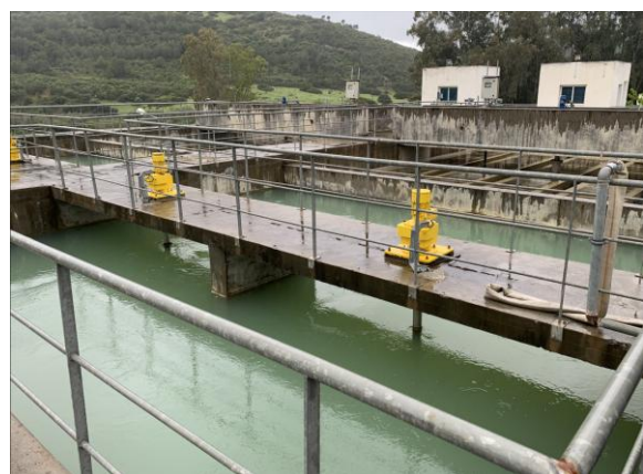
本事業で建設された浄水場（出典：評価者撮影）
