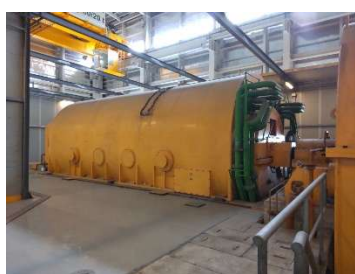
写真 1：発電機ユニット 1 タービン (出典：評価者撮影)
