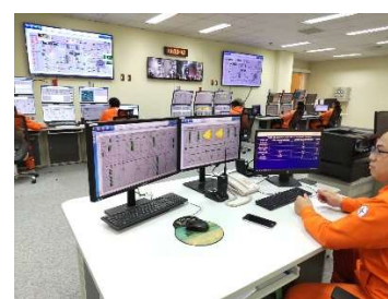
写真 4：中央制御室 (出典：評価者撮影)
