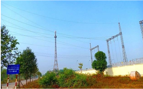
写真1：整備された変電所 (出典：評価者撮影)
