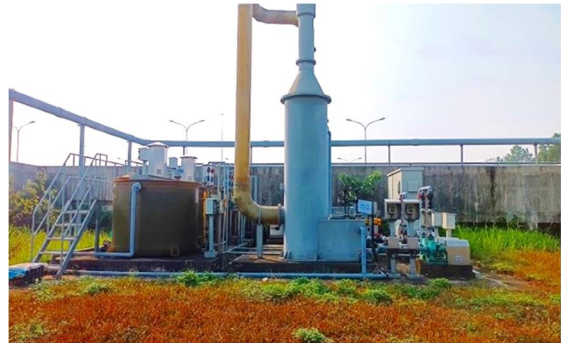
写真4：導入された下水処理施設内の 臭気処理装置 (出典：評価者撮影)
