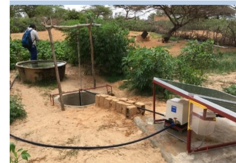
ソーラーポンプシステム
