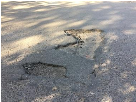
キルギスにおける道路の損傷
