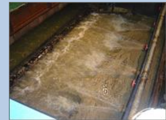
スカムを除去する省電力型装置。 写真は、処理中の様子
