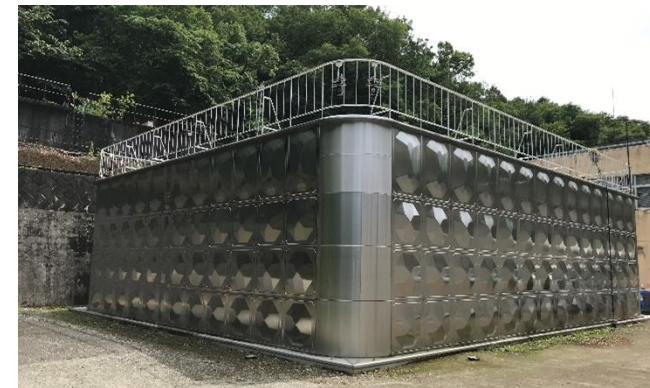
埼玉県深谷市 ステンレス配水池 容量1000 m 3
