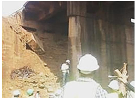
ザンビア国の橋台コンクリート脱落の様子
