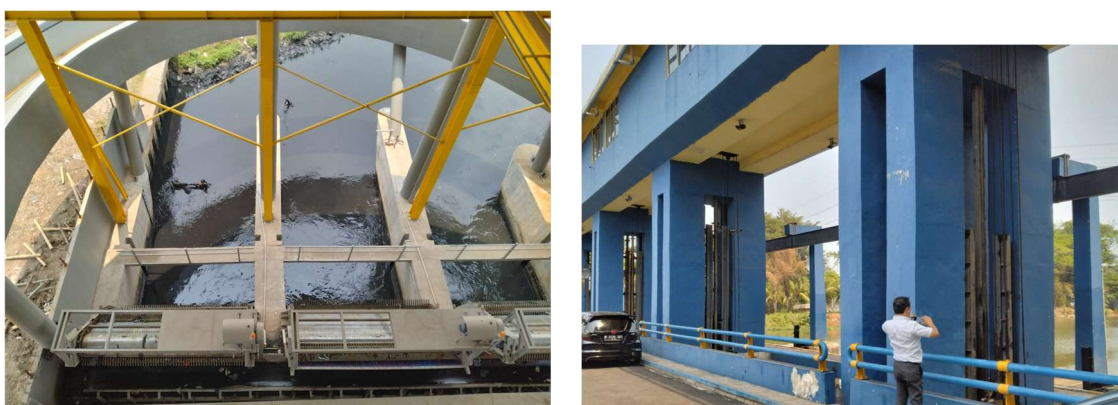
図3：水門(主として揚水用途) (左図：揚水設備 / 右図：施設概観)
