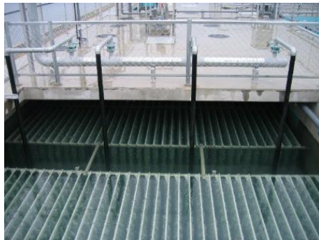
写真8 金属加工工場排水処理
