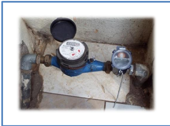
常設型自動漏水監視装置(L-sign)
