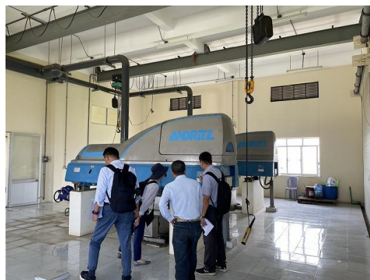
Vung Tau 下水処理場
