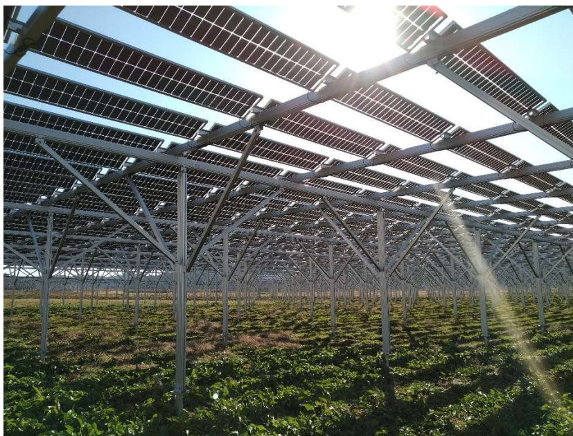
写真 1 当社が SS に使用する細型太陽光パネルの日本国内導入例（千葉県匝瑳市）
