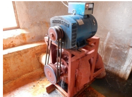
図 22 民間エンジニアによる小水力発電装置 (上部が中国製発電機で下部が水車)
