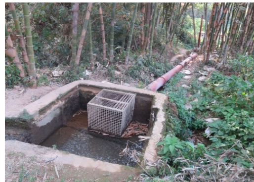
図 11 自然の地形（落差）を生かした小水力発電の設置事例
