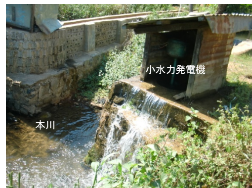
図 16 発電地点（左写真の下流側）
