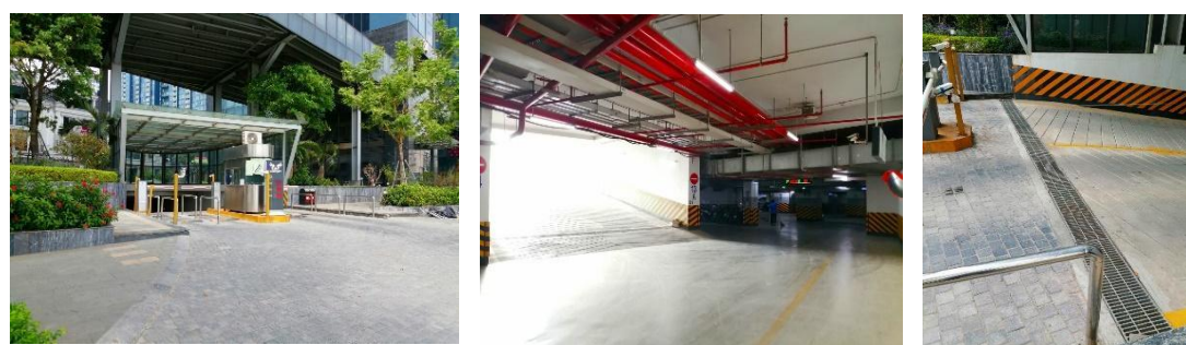
写真 8 ポンプ排水対策された地下駐車場の様子
