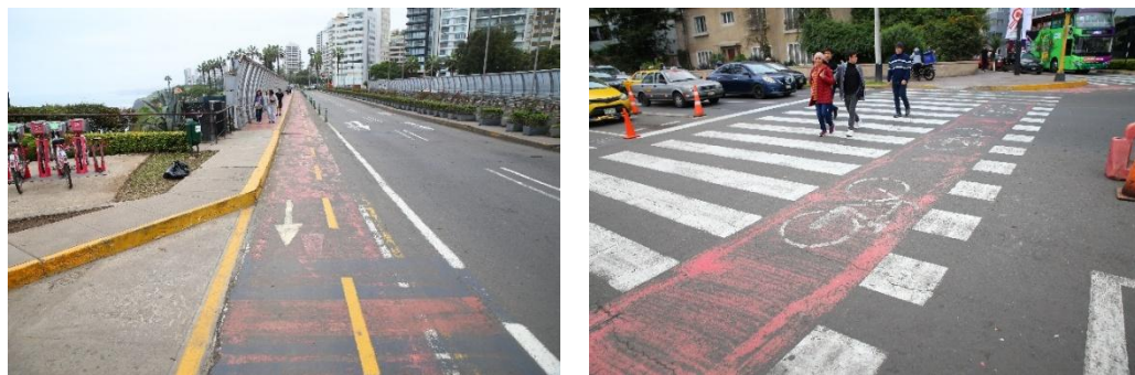
図4 自転車道における塗装の摩耗・剥離状況
