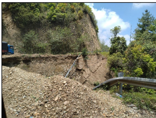
図 2-2 道路基盤の崩壊例
