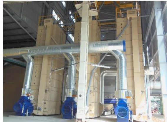
籾殻燃料炉で稼働する 10 トン容量のコメ乾燥機
