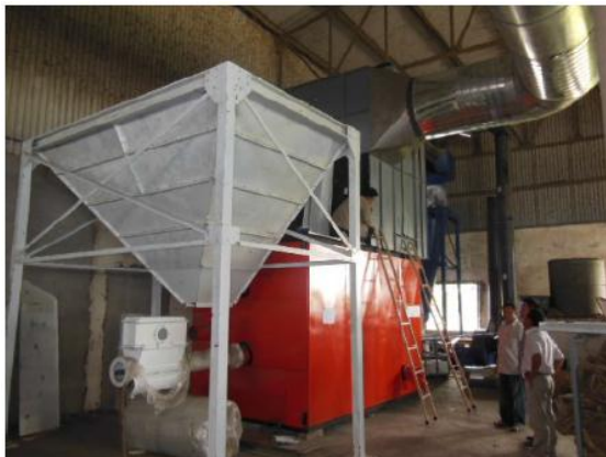
乾燥機の熱源となる籾殻燃料炉
