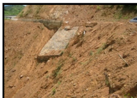
図 1-4 法面災害事例
