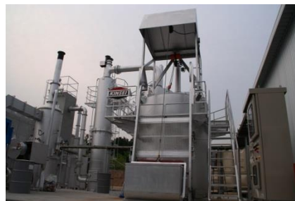
乾溜ガス化焼却装置
