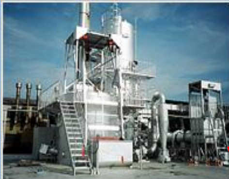
乾溜ガス化焼却装置
