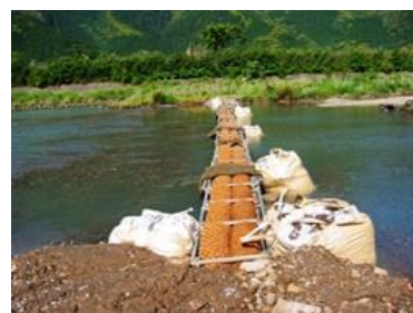
バイオログフィルター(写真:南西環境研究所)
